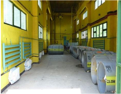
Butelii de clor gazos folosite la dezinfectarea apei
