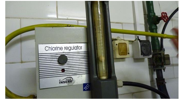
Instalație folosită pentru dozarea clorului
